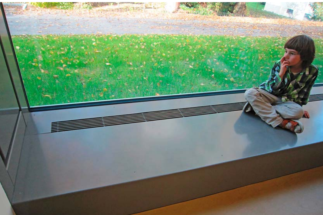
Eine ausreichende Lufterneuerung ist eine Grundvoraussetzung für die optimale Konzentrationsfähigkeit von Schülern. (Foto: hässig sustech gmbh)
